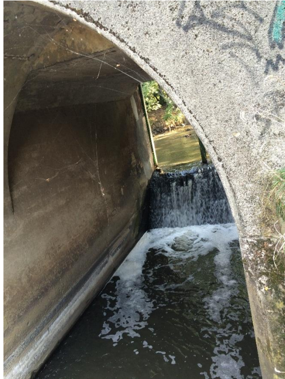
Widok od wody dolnej na przelew przez próg jazu stałego przy rzędnej zwierciadła wody \sim 198,50 m nKr.
